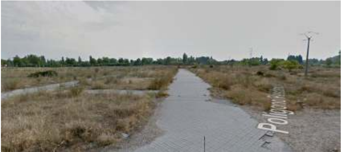
Foto 1.-ESTADO DE LAS ACERAS DE LA URBANIZACIÓN EJECUTADA
