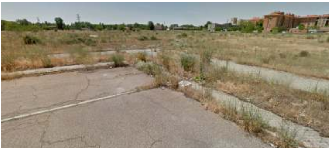
Foto 3.-LAS HIERBAS INVADEN LAS OBRAS DE URBANIZACIÓN EJECUTADA.
