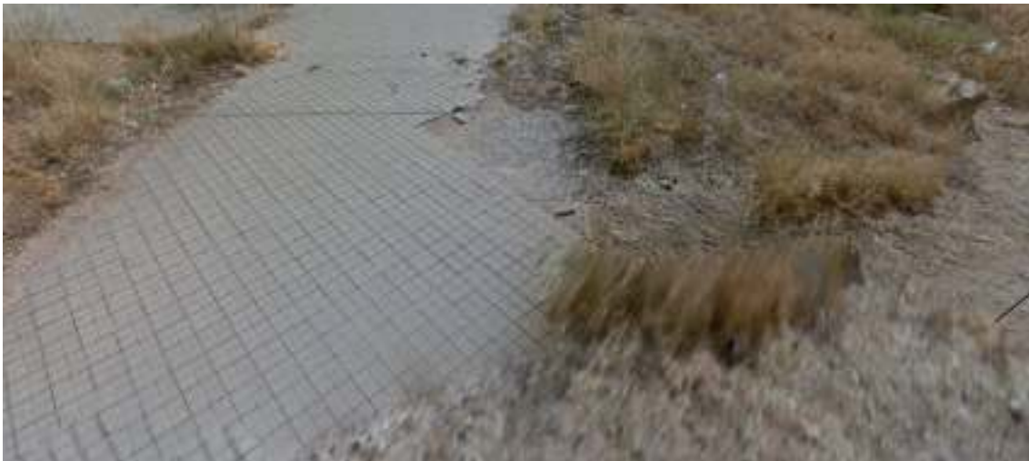
Foto 2.- LA FALTA DE MANTENIMIENTO HA IDO QUE EL DETERIORO DE LA URBANIZACIÓN PROGRESE.
