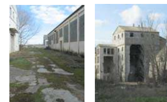
Pavimento Derribos parciales
